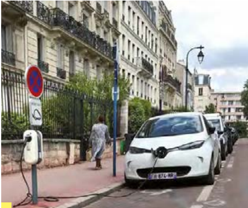
En 2019, la Métropole du Grand Paris a lancé un appel à initiatives privées pour faire installer des bornes de recharge électrique en lieu et place des anciennes stations Autolib'.
